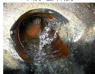
不明水*侵入の様子
