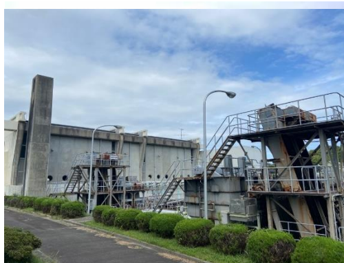
老朽化が進む北白土第一ポンプ場
