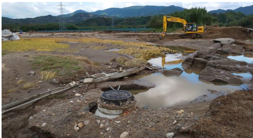
下小川地区の管路の流失
