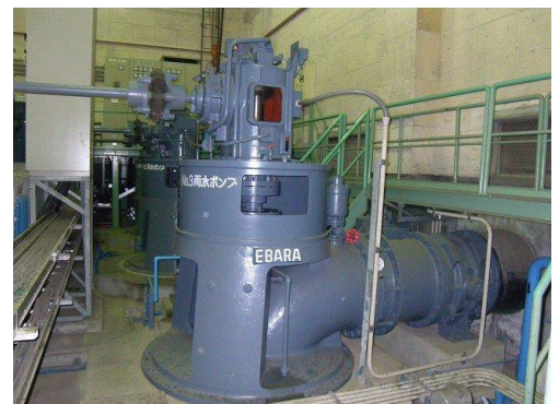
写真 6-2 ポンプ施設状況
