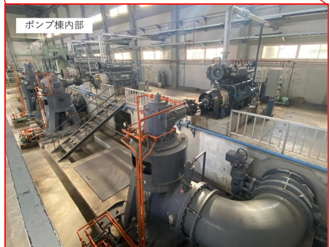
写真4-2 北部浄化センター雨水ポンプ設備
