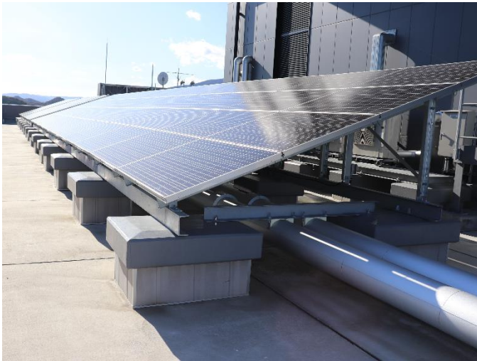
再生可能エネルギーの導入 （いわき市医療センター）
