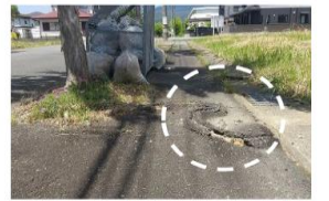
(根上りにより通行に支障のある事例)
