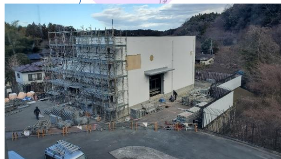
山玉浄水場 停電対策(R8竣工予定)
