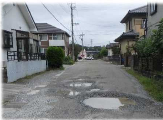
市道 一町坪5号線（整備前）
