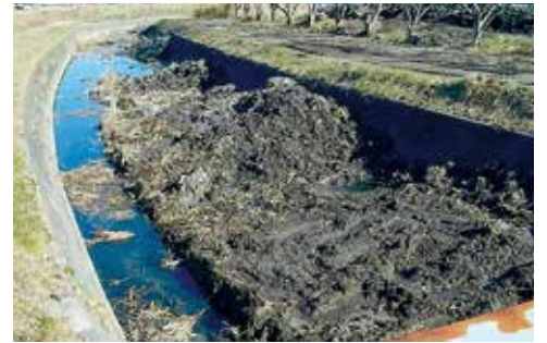
▲土砂撤去前の河川
