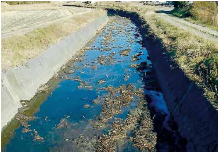
▲土砂撤去後の河川
