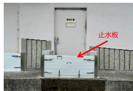
好間ポンプ場 止水板対策後(令和6年度)
