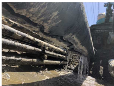
老朽化により漏水した水道管
