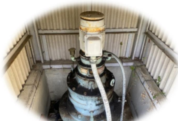
②No.1汚泥掻寄機
