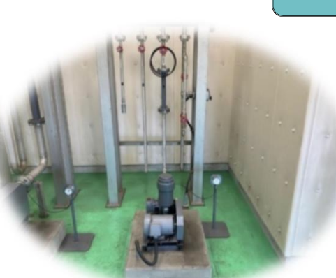
③曝気沈砂槽ブロワ
