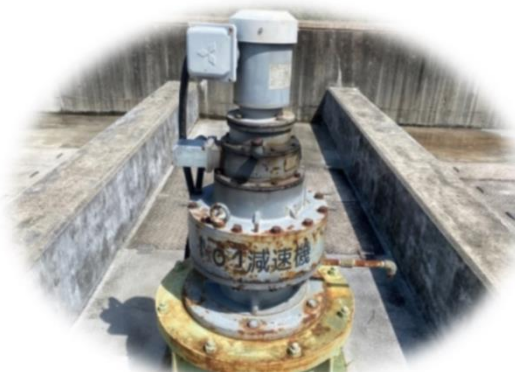
①No.1汚泥掻寄機
