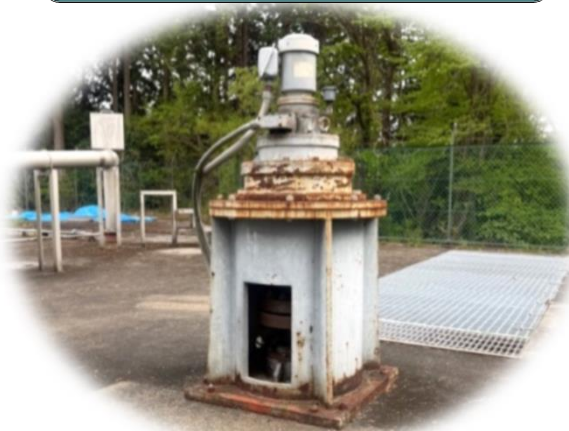
②汚泥掻寄機
