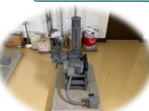
②汚泥貯留槽ブロワ
