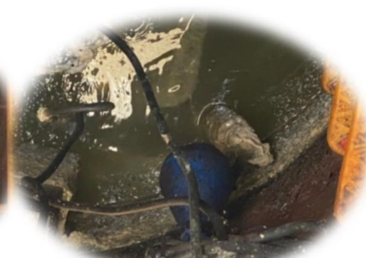
④マンホールポンプ水位計
