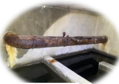
①消毒槽配管
