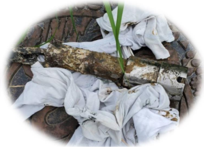
②マンホールポンプ水位計
