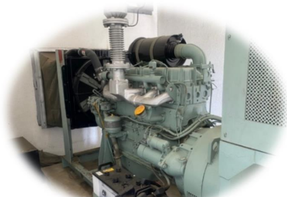
①非常用発電機
