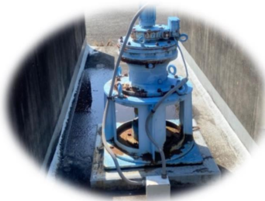
①No1汚泥掻寄機
