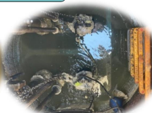
③マンホールポンプ
