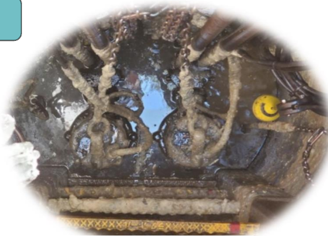
①マンホールポンプ
