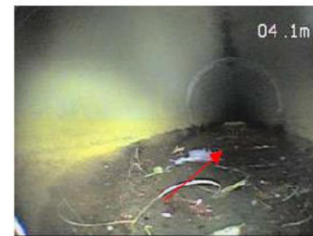
③市道天王崎7号線から 暗渠雨水管に繋がる暗渠 部の状況 (断面の1/3程度が堆砂)
