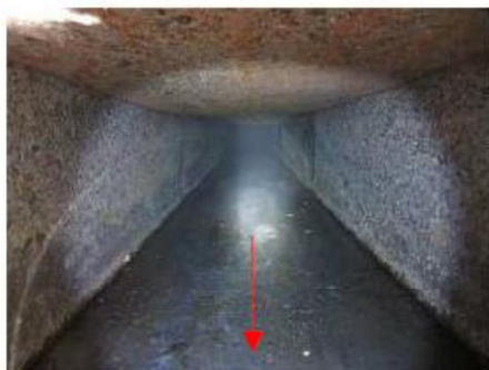
①暗渠雨水管の内部状況 (堆砂高 H=45cm)
