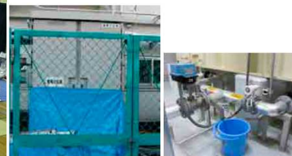
(蓄電システム装置・受水槽に取り付けた蛇口)
