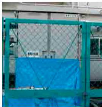
蓄電システム装置
