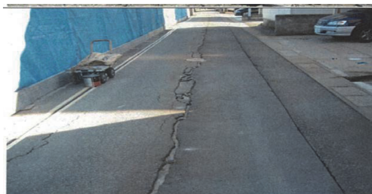
写真 2.3.1 道路のクラック状況
