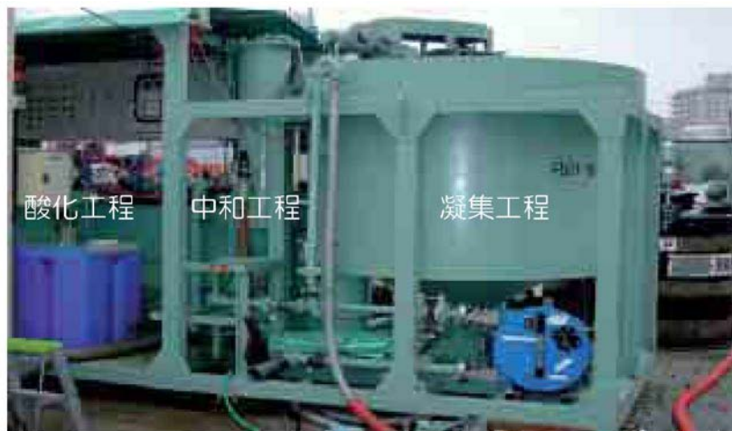
図 8-13 酸化、中和、凝集装置の概況写真
