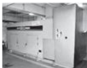
上野原浄水場の非常用自家発電設備
