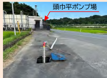
消火栓から給水を可能とした様子
