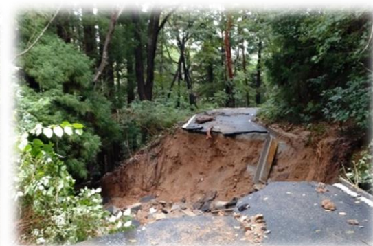
【林道】櫓石線(路体崩落)
