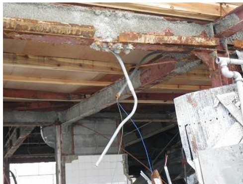
建物に残存した吹付け材
