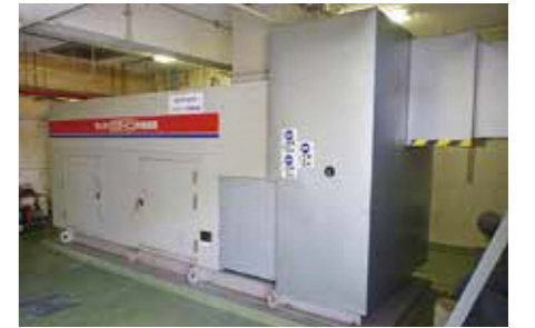
上野原浄水場の非常用自家発電設備
