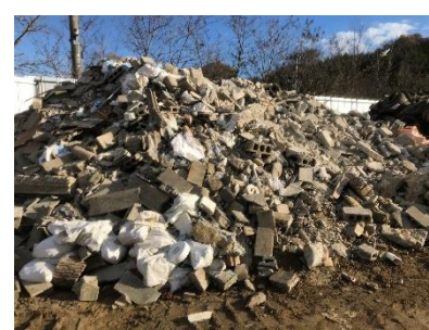
コンクリートがら
