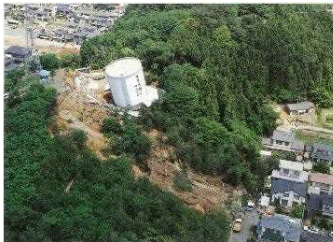
図 平成9年の土砂流出災害に伴う常磐配水池の被害状況
