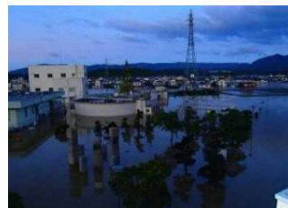
図 令和元年東日本台風における平浄水場の浸水被害状況
