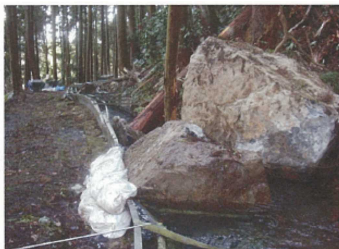
図 東日本大震災における大滝江筋用水路の被害状況
