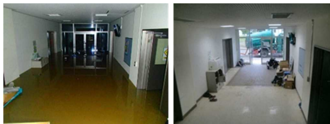
管理棟（電気室・ポンプ室・薬品注入室入口） （浸水深 床上から約62cm）
