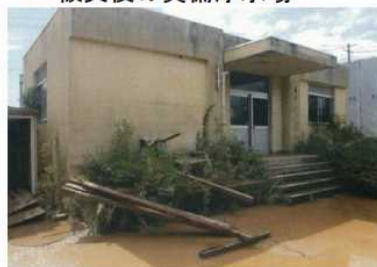
被災後の真備浄水場
