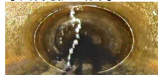
【不明水侵入の様子】
