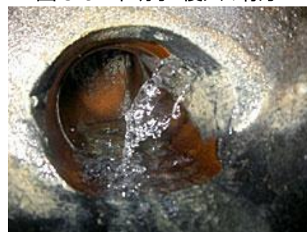
図 5-9 不明水*侵入の様子
