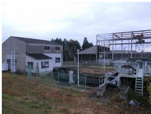
図 5-2 老朽化が進む芳川ポンプ場
