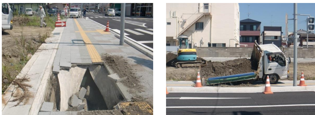
図 5-6 老朽化した管きよによる陥没事故の状況（小名浜地区）
