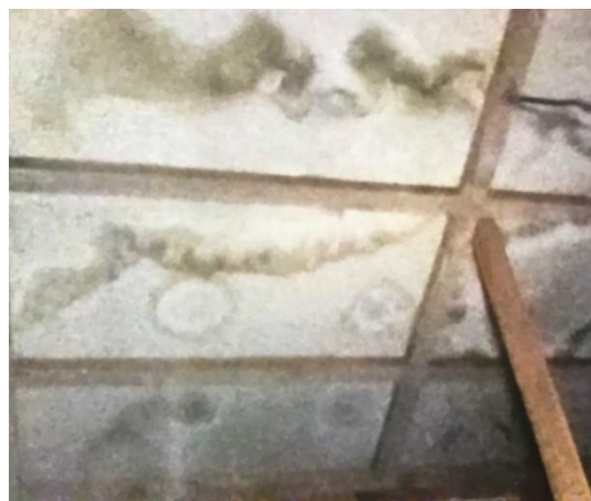
天井の雨漏り
