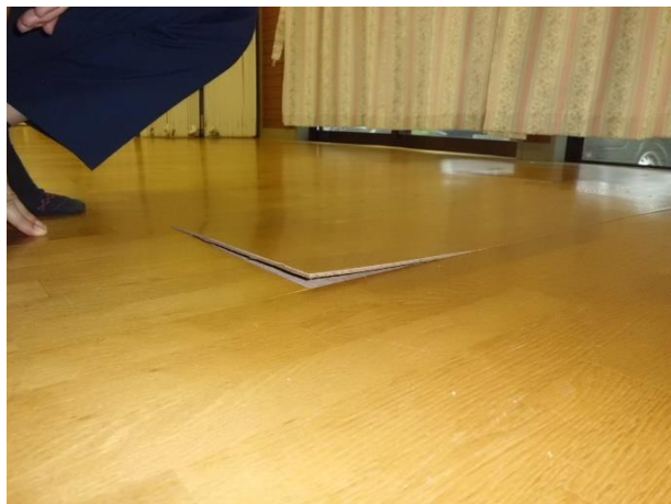
床板の剥がれ
