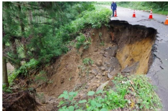
崩落した市道の状況（田人地区）
