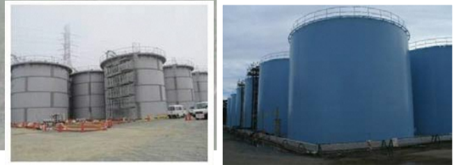
タンクの設置状況
