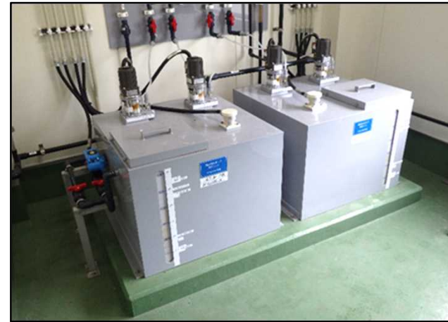
写真 追加塩素注入設備 平第 2 配水池
