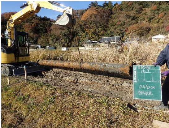
写真 老朽管の状況
