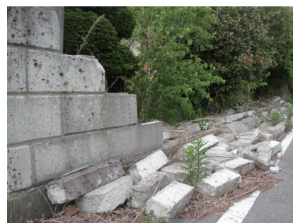
地震により石塀が倒壊
