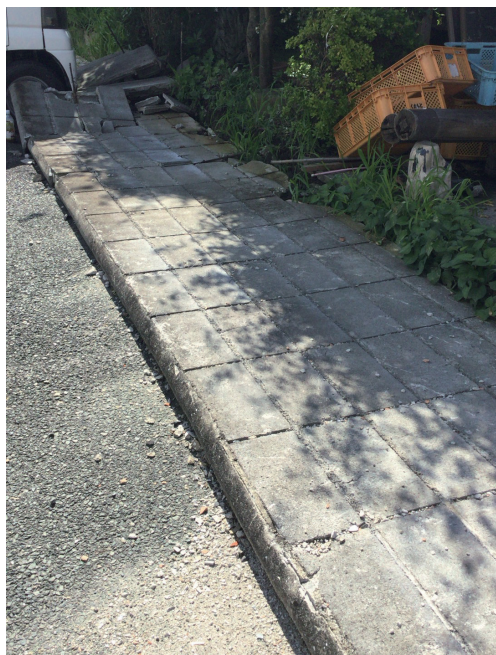
地震によりブロック塀が倒壊
