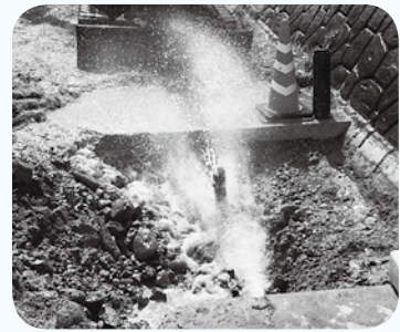
給水管の漏水事故
