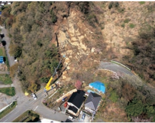
写真2-43 崖崩れで市道が交通遮断 (市道宮沢～蛭内線) 〔4月26日 いわき市撮影〕
