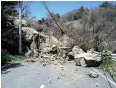
写真2-12 内郷宮町桜本地内に通じる市道宮沢―蛭内線の法面崩落〔4月17日 いわき市撮影〕
