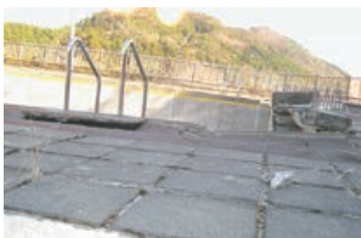
写真2-7 連続して起こった断層のズレ上にあった田人中学校のプール 〔4月13日 いわき市撮影〕
