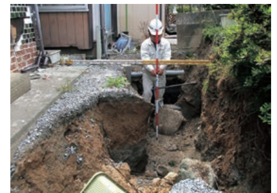
写真2-4 軟弱地盤であった、植田町根小屋の被害 〔5月 いわき市撮影〕
