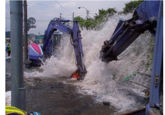
漏水事故(φ500mm配水管漏水)
