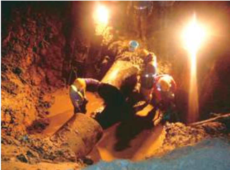
写真3-11-47 山玉浄水場送水管の漏水修理 [平成23(2011)年3月 市水道局提供]
