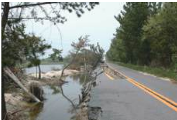
写真3-11-82 津波の勢いを弱めた防潮林と被災した県道豊間-四倉線 [平成23(2011)年6月 いわき市撮影]
