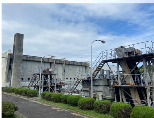
老朽化が進む北白土第一ポンプ場
