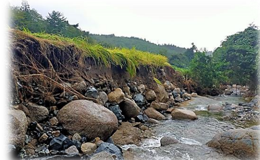
【河川】普通河川 相川(河岸崩落)
