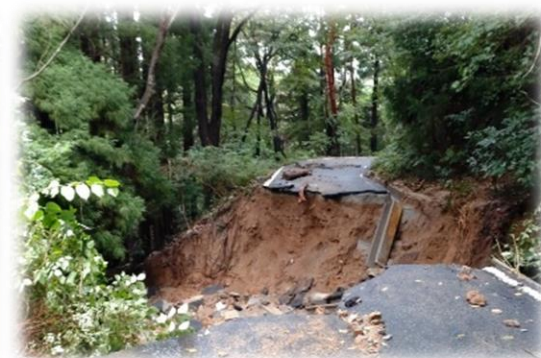
【林道】櫓石線(路体崩落)
