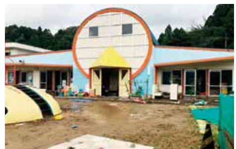
▲床上浸水の被害を受けた宮幼稚園（9月9日撮影）
