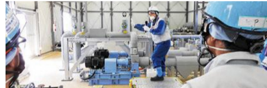
ALPS処理水移送ポンプの確認状況
