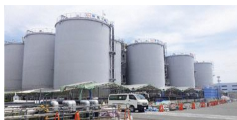
ALPS処理水中の放射性物質濃度を測定するタンク群
