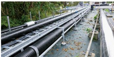
ALPS処理水移送配管
