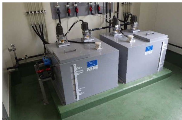
追加塩素注入設備 (平第2配水池)
