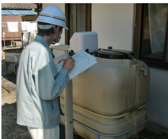
小規模貯水槽水道の無料点検の様子
