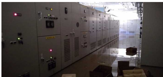
電気室の浸水
