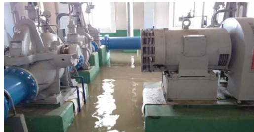
送水ポンプ室の浸水
