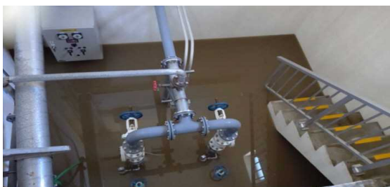
2系濃縮槽地下、汚泥引抜ポンプの水没
