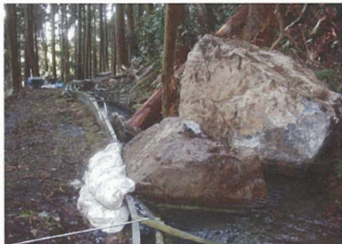
図 東日本大震災における大滝江筋用水路の被害状況
