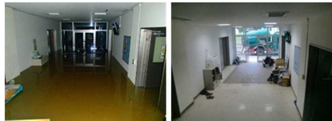
管理棟(電気室・ポンプ室・薬品注入室入口) (浸水深 床上から約62cm)
