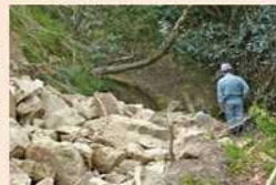
落石により大滝江筋用水路が閉塞(平成23年)
