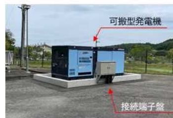
田部ポンプ場の可搬型発電機(令和4年度)
