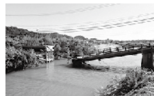
落橋した大久川の禰宜内橋
